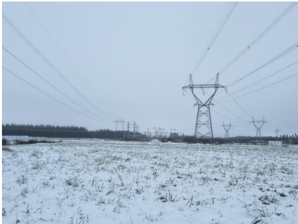
Kuva 6. Koillisessa sijaitseva sähköasema.
