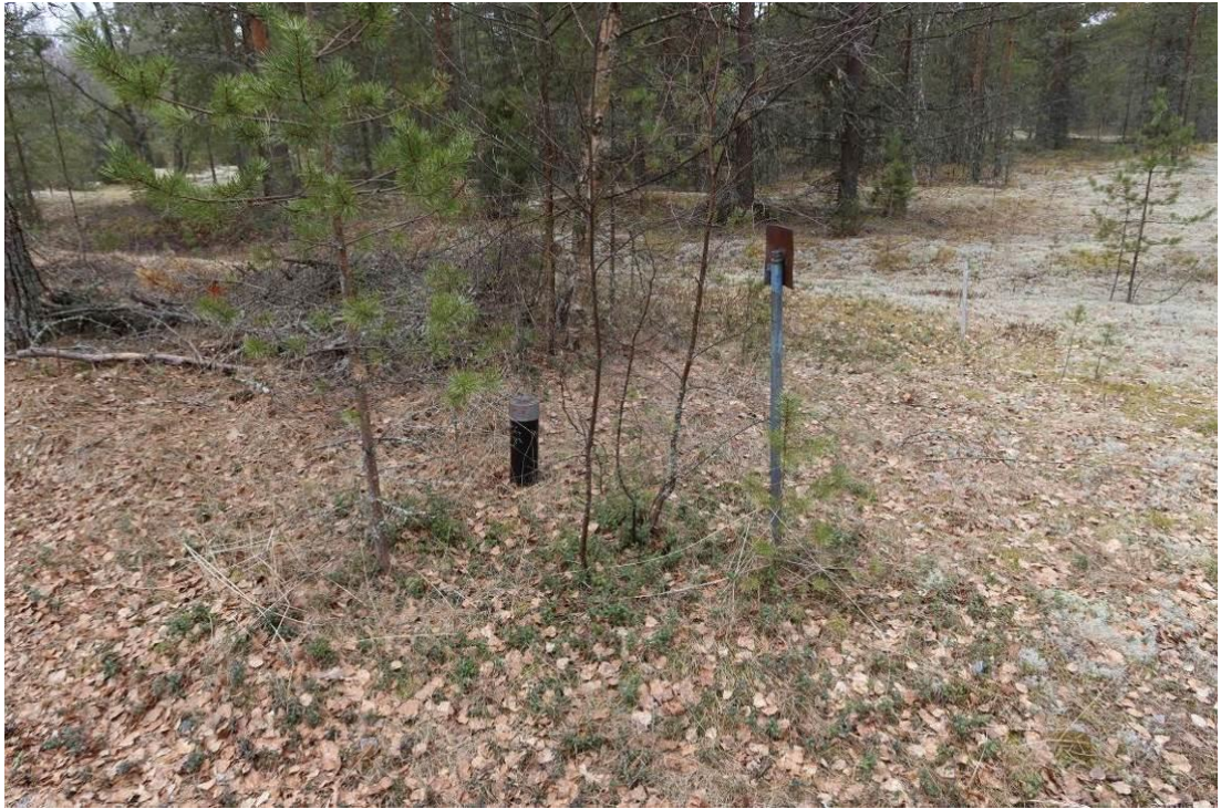
Kuva 11 Vesijohtoverkoston laitteita (Kuva: Kimmo Mustonen 1.5.2025)
